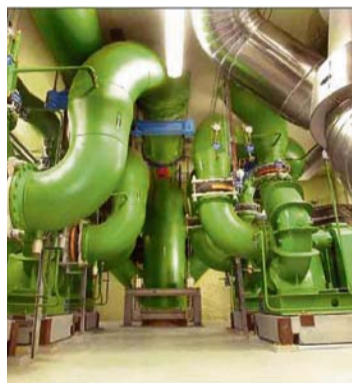
Installations de refroidissement sous la place du Canada (8 e ). CLIMESPACE
