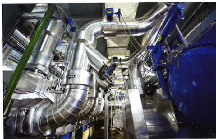
La centrale de froid de CLIMESPACE située sous le Palais de Tokyo à Paris.
